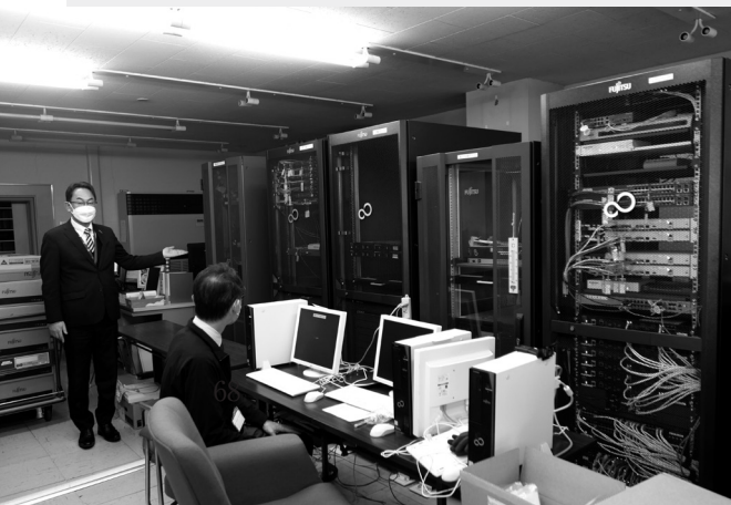
サーバー室に並ぶサーバーラックを示す荒木田理事
